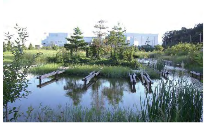
↑修景池の北側から中島を望む 能舞台および八つ橋の基礎と大引き 中島には能舞台の借景としてクロマツ等を配置
